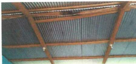
Foto 2: Estructura de techo deteriorada.
