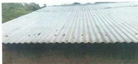
Foto: Vista laminadas deterioradas.
