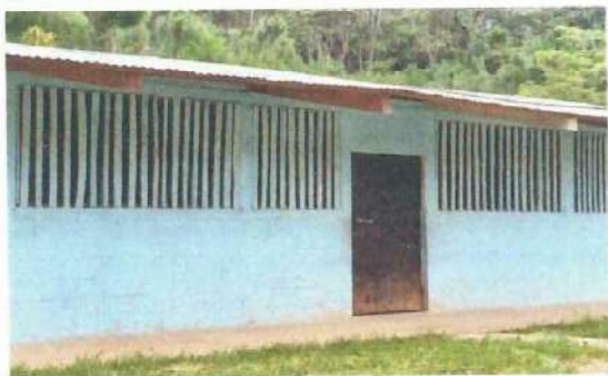
Foto1: Panorámica Ineb de Telesecundaria, techo de modulo I deteriorado.
