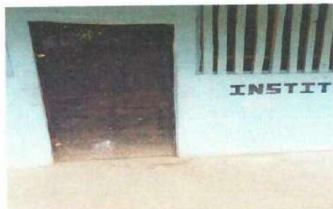
Foto 3: Puertas y ventanas de aulas deterioradas.
