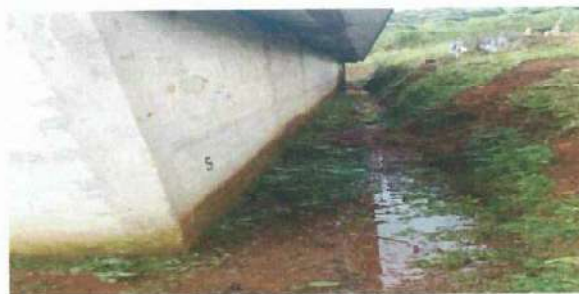
Foto 4: Paredes lado posterior modulo I con humedad.
